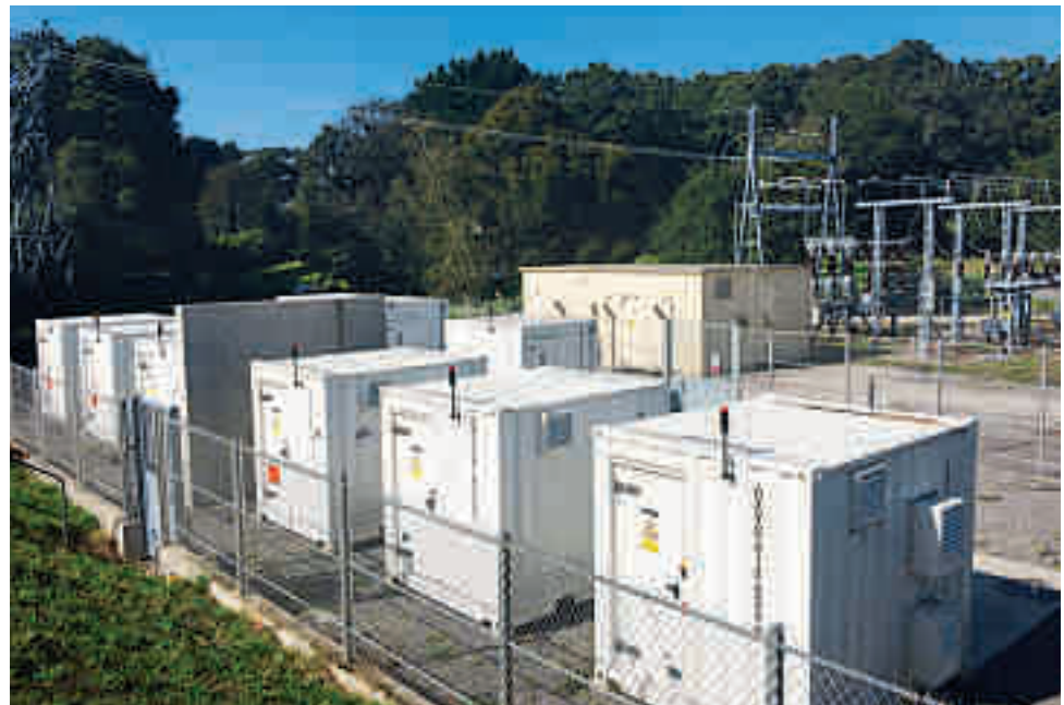
Les packs, grandes surfaces de stockage en vue de l'hébergement des batteries électriques.
